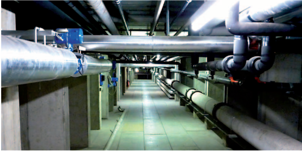
Der begehbare Energiekanal auf dem Höggerberg wird aus Sicherheitsgründen geschlossen.
